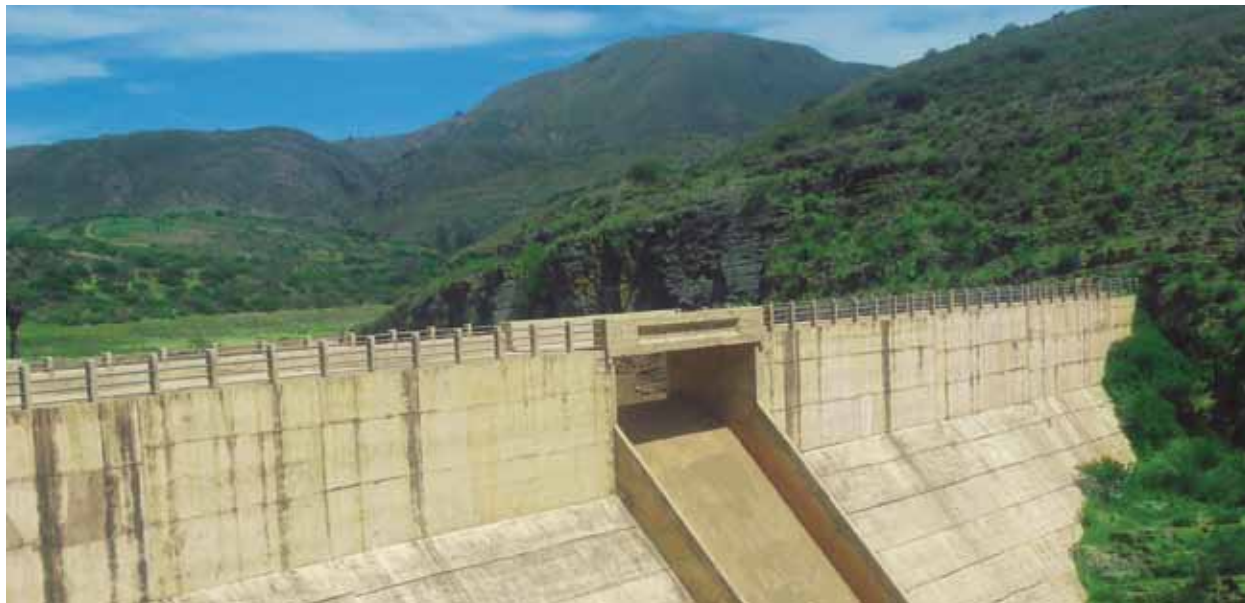
Foto 7: Represa Laka Laka con problemas de colmatación.
